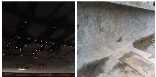
Hình 10: Các vết nứt ở đáy và sườn dầm khu vực giữa nhịp
